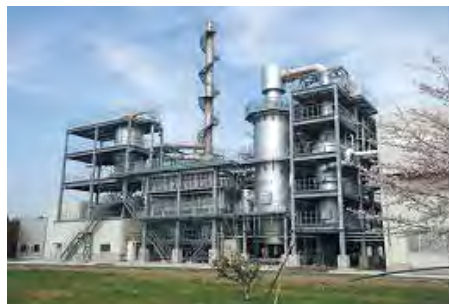
中川水循環センター 出展:埼玉県ホームページ
