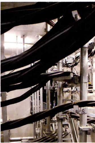
共同溝:内部には重要な通信ケーブルなどもあるため、24時間体制で集中管理されている。そのため、普段、見学することはできない。
