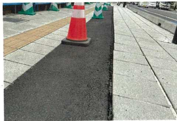
(沈下当時の状況)
