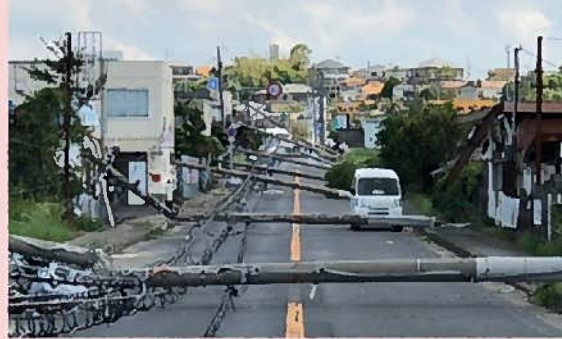
台風による電柱倒壊(大阪府泉南市)
