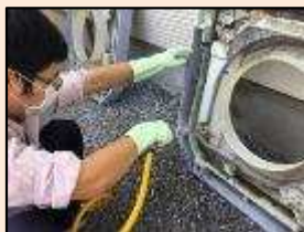
ドレンパンの高圧 洗浄
