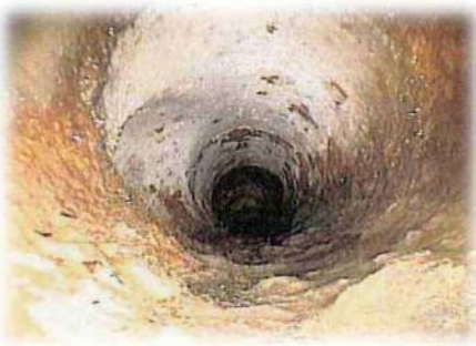
▲配管の劣化状況
