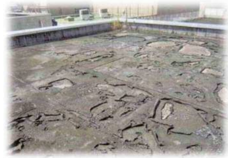
▲屋上防水の劣化状況
