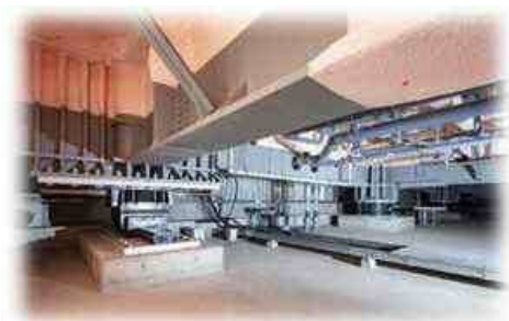
▲参考事例 地下免震装置 (越谷市役所) 出典：越谷市ホームページ
