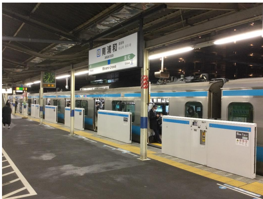
図 2-24 京浜東北線南浦和駅 4 番線（北行）に設置されたホームドア
