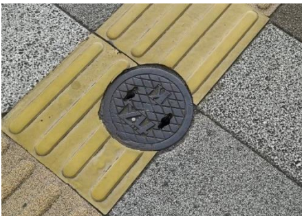
マンホール・ハンドホール
