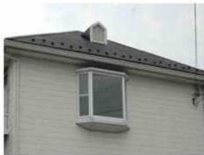
アスベスト含有蕁業系サイディング (外壁)
