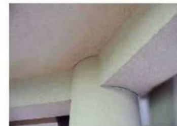
アスベスト含有吹付けパーライト（天井）
