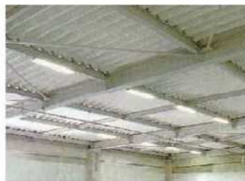
アスベスト含有屋根用折板断熱材（天井）
