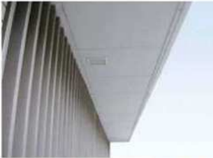
アスベスト含有けい酸カルシウム板第1種 (軒天)
