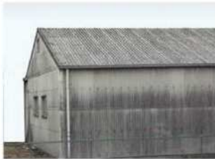
アスベスト含有スレート波板 (屋根)
