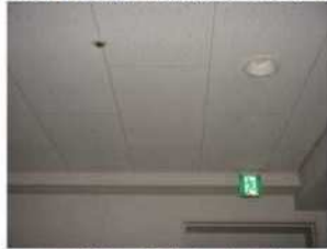
アスベスト含有石膏ボード (天井)
