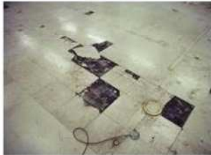
アスベスト含有ビニル床タイル (床)
