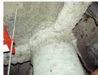
吹付けアスベスト（梁）
