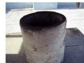
アスベスト含有煙突用断熱材（煙突）
