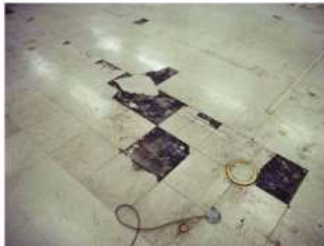
アスベスト含有ビニル床タイル (床)
