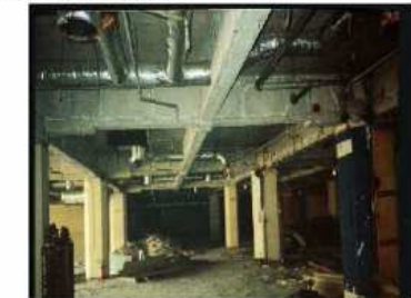
アスベスト含有けい酸カルシウム板第2種（天井）
