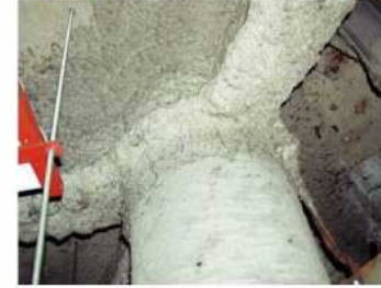
吹付けアスベスト（梁）
