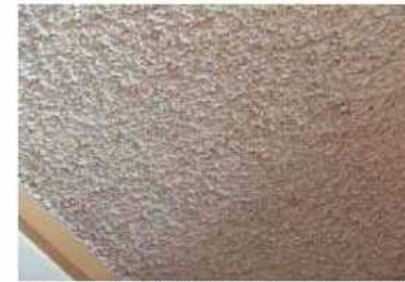
アスベスト含有吹付けパーミキュライト（天井）
