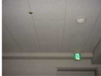
アスベスト含有石膏ボード (天井)
