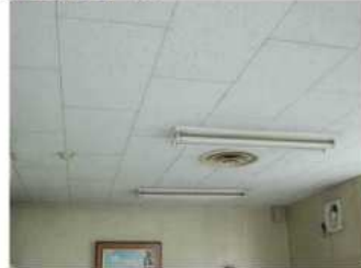
アスベスト含有ロックウール吸音板 (天井)
