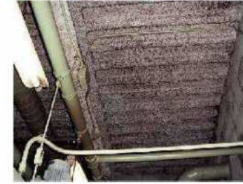
アスベスト含有吹付けロックウール（天井）
