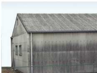
アスベスト含有スレート波板 (屋根)
