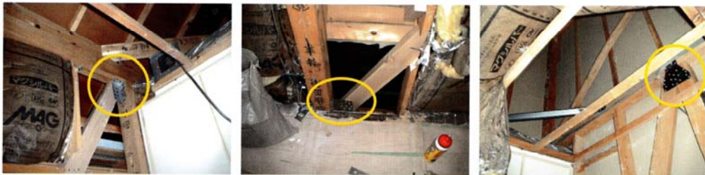
筋かい金物を取り付け、地震時にはずれることを防止する
