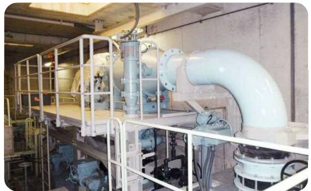
小水力発電 (深作配水場)
