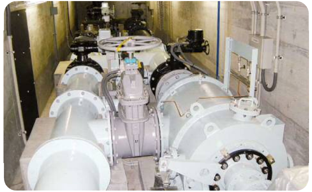
小水力発電 (尾間木配水場)
