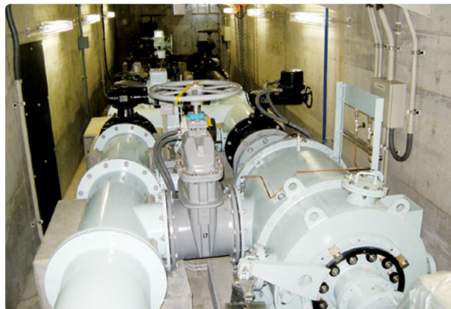
小水力発電（尾間木配水場）
