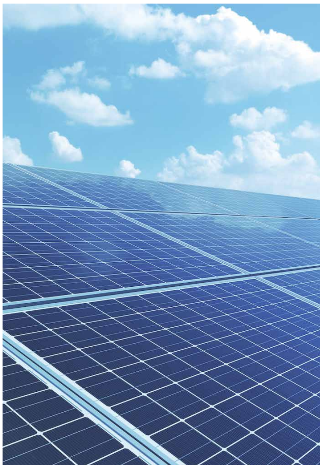
写真：太陽光パネル
