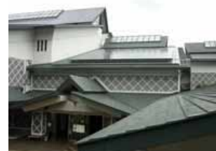
太陽光発電システム （大宮武道館 32kW、H22 導入）
