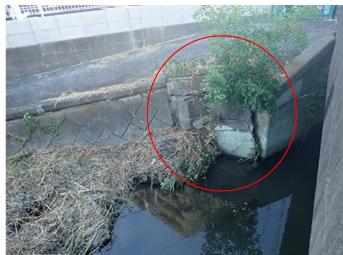
護岸に亀裂を確認
