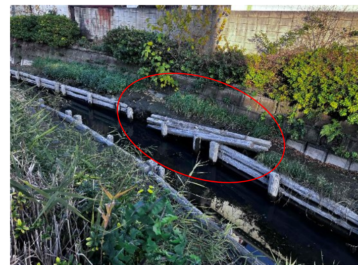
木柵の欠損と、それに伴う 護岸の崩れを確認
