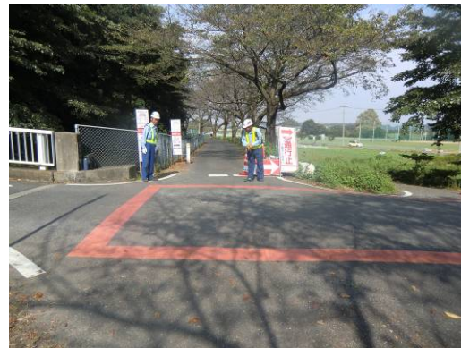
②米原橋 通行止めの様子
