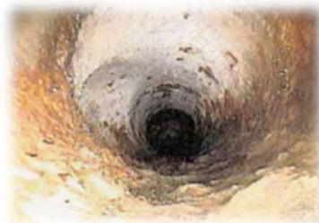
▲配管の劣化状況
