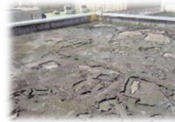
▲屋上防水の劣化状況
