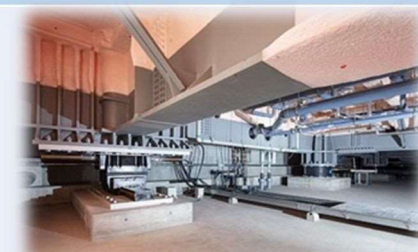
▲参考事例 地下免振装置 (越谷市役所) 出典：越谷市 HP
