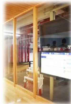
黒松内小学校 (北海道 寿都郡黒松内町) ガラス張りの機械室。 表示モニターに地中熱ヒートポンプによるエネルギー量と太陽光発電による発電量を表示 資料:文科省 HP(学校施設整備・活用のための共創プラットフォーム)より
