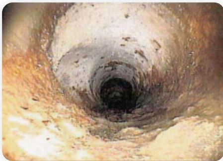
▲配管の劣化状況
