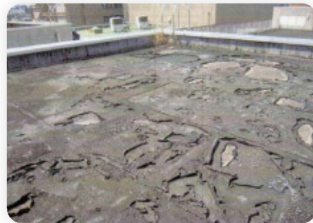
▲屋上防水の劣化状況
