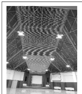
体育館の照明
