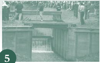
5 一の開に角落板を7枚取り付け付けたところ。3の写真と比較すると、水位が上昇していることがわかる(実演開始後、約50分経過)
