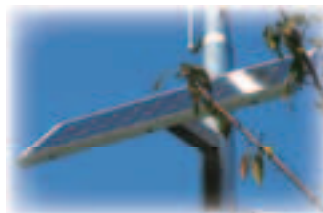
▲太陽光発電システム
