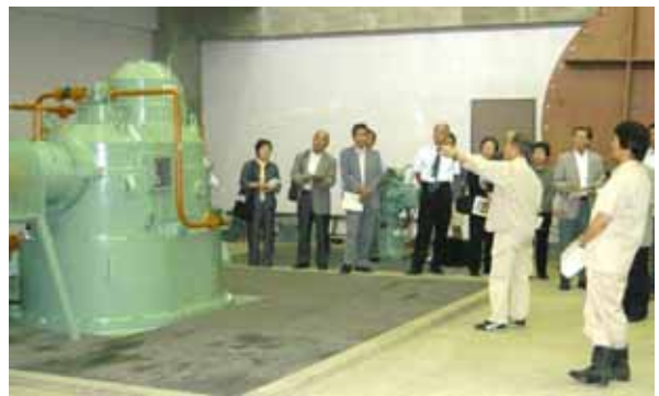
排水機場の主役は巨大なポンプ
