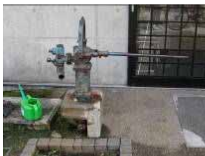
井戸や雨水利用で使われる手押しポンプ
