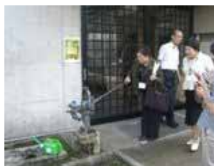
災害時にも使えるように手押しポンプが設置されている。
